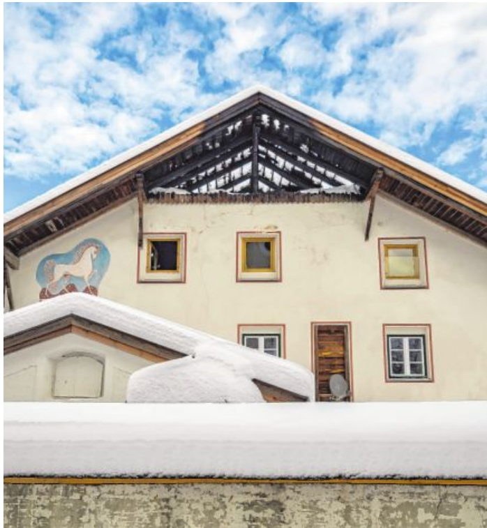
Seit dem Frühjahr 2023 lässt der zerstörte Dachstuhl des Weissen Rössls Regen und Schnee durch.
